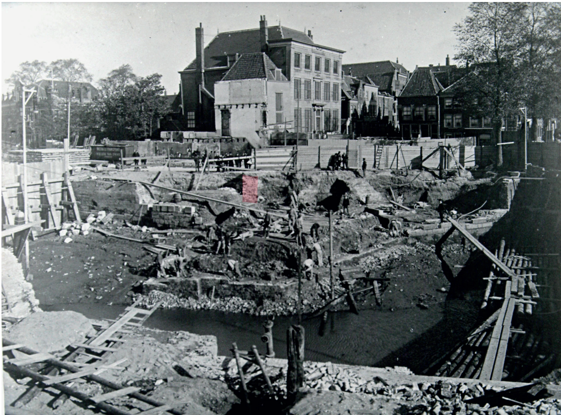
Afb. 17. Een foto van de sloopwerkzaamheden in de periode 1910-1911. Een groot deel van de kadebeschoeiing van de Nieuwe Haven die bestaat uit natuurstenen blokken (waarschijnlijk blauwe hardsteen) is verwijderd. Op de voorgrond is men bezig het noordelijke brughoofd van de oude brug te verwijderen (vergelijk met afb. 12). Het pand Blauwpoort is al vrijwel geheel gesloopt. In rood is de vermoedelijke fundering van de 15 e -eeuwse (?) stadsmuur te zien (RAD inventarisnr. 555_14269).
