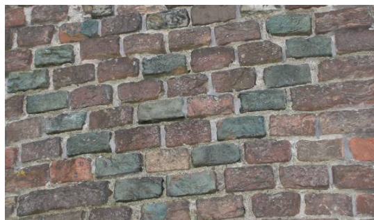
Afb. 24 Vermoedelijk negentiende- of vroeg twintigste-eeuwse herstelling met bakstenen die verglaasd zijn met een oppervlakkige glazuurlaag. Zuidwest hoek van de toren.
