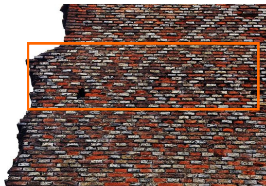
Afb. 21 Een fout in het sierwerk van de noordgevel. Twee halve ruiten zijn in elkaar geschoven.
