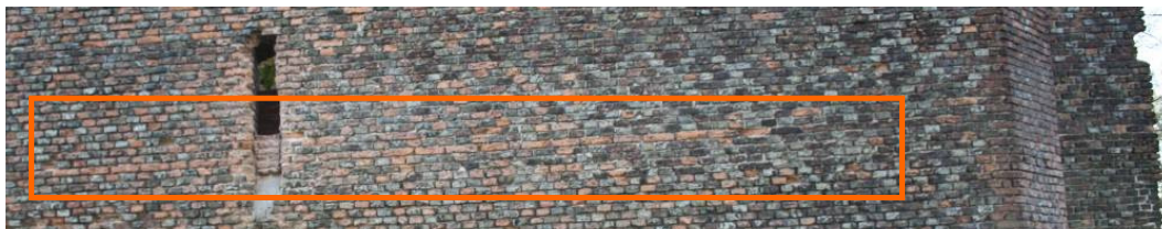
Afb.20 In de westgevel is in een hele laag het ruitpatroon vergeten. Dit is een laag van alleen rode bakstenen.
