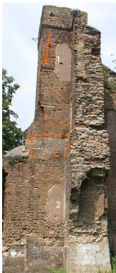
Afb.75 sporen van dakmoet en balklaag
