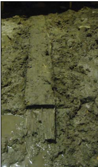
Afb. 7. Eén van de 19-eeuwse dwars-georiënteerde funderingsbalken ter hoogte van een funderingspaal. In de inkeping is de ijzeren nagel te zien. De funderingsbalk in de lengterichting is hier (al) verwijderd.
