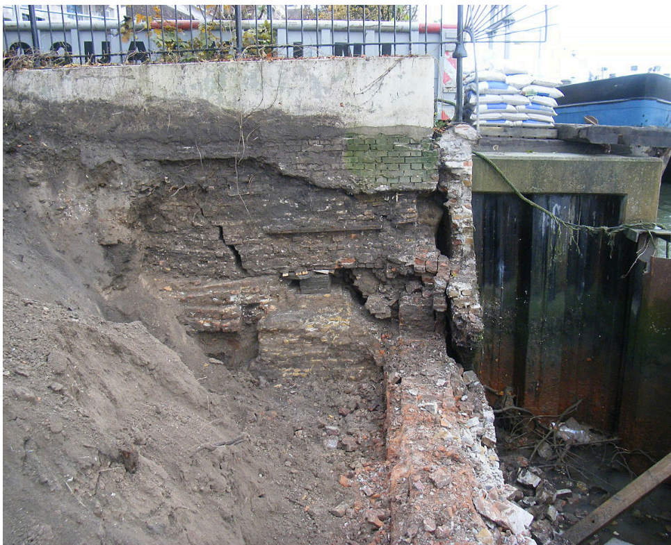
Afb. 17. Het zuidwestelijk bodemprofiel met daarin een poer S3 (van het theehuis) en verschillende fases van jongere perceelscheidingsmuren langs de Veersteiger/Buiten Walevest (zie ook afb. 13).
