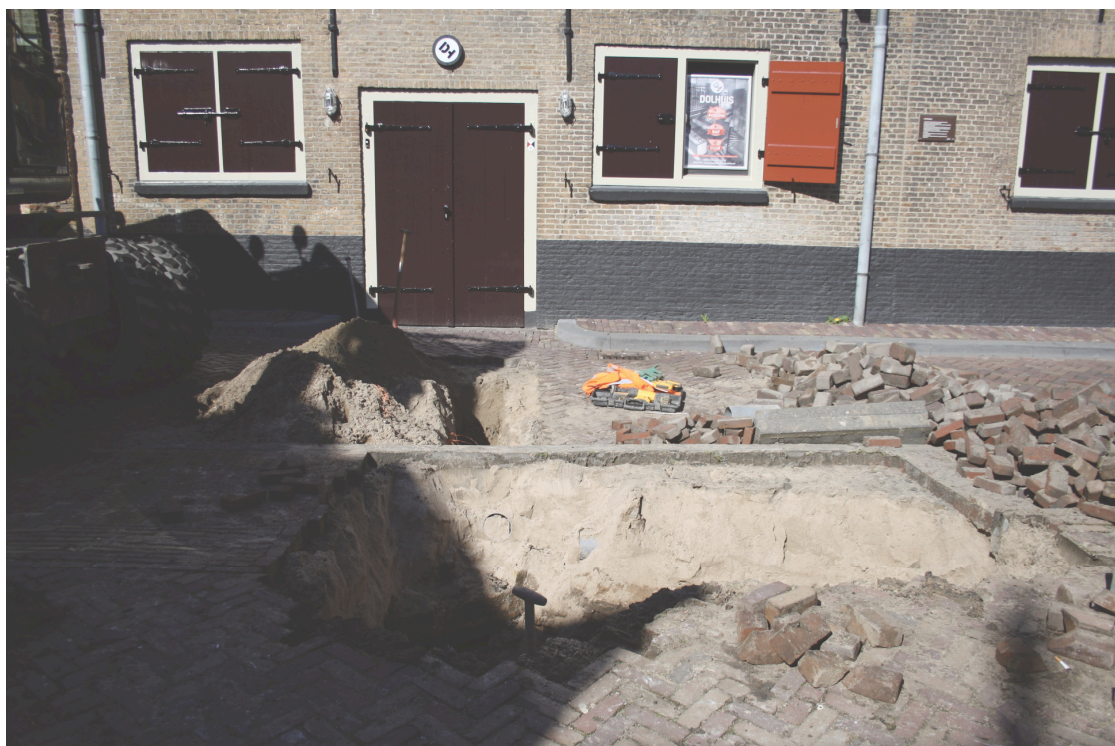
Een overzicht van de begeleide graafwerkzaamheden op de hoek van de Dolhuisstraat en Boogjes, gezien tegen de gevel van het Dolhuis.
