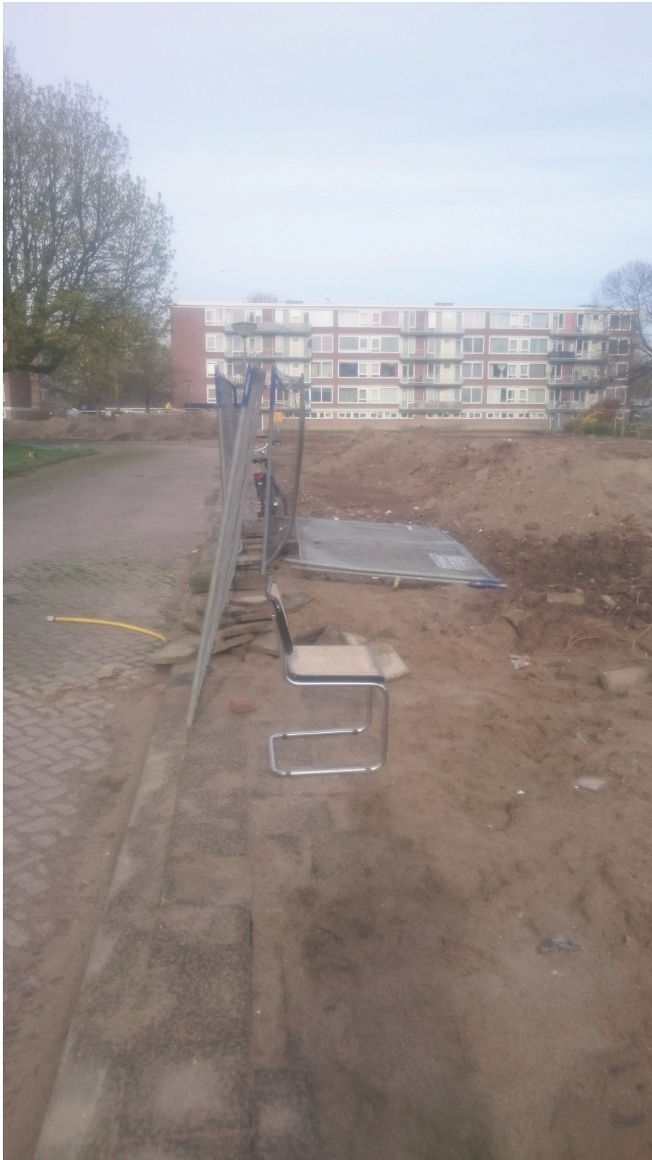
Het plangebied ten tijde van het onderzoek, gezien vanuit de noordoostelijke hoek in de Wiarda Beckmanplantsoen in westelijke richting. Links de straat waarin het nieuwe riool zal worden gelegd. Rechts en achter: de locaties van de gesloopte bebouwing.
