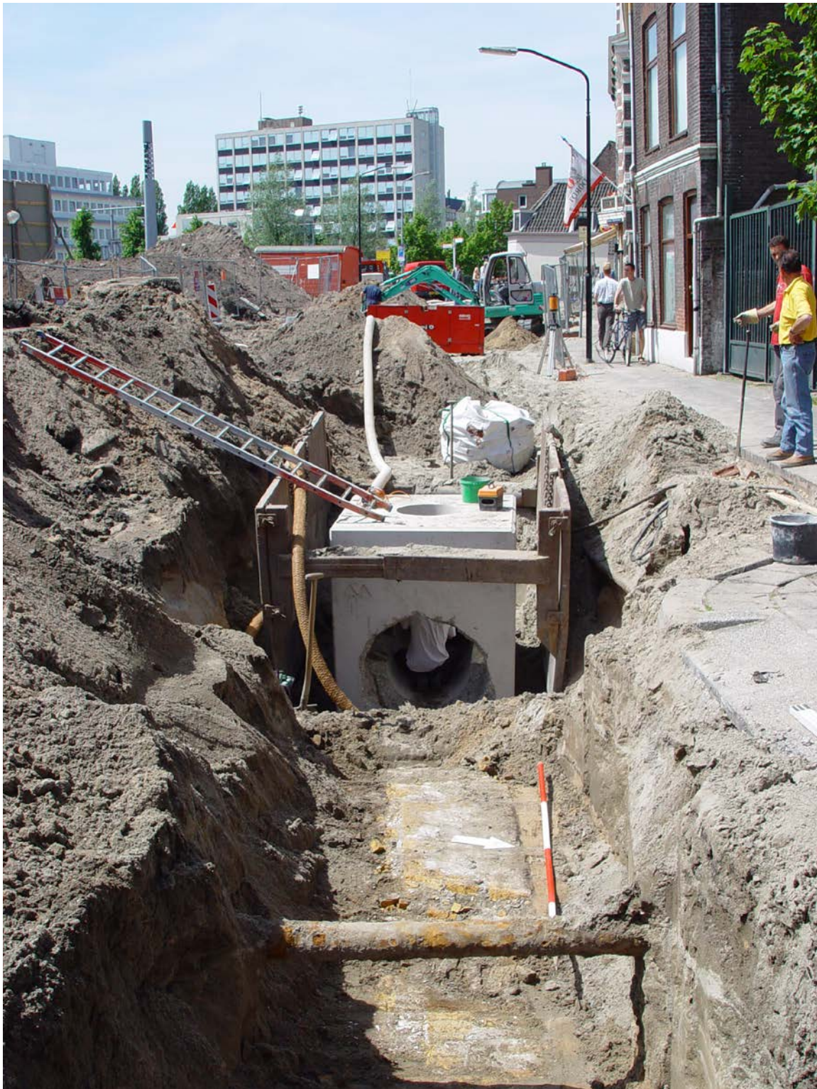
Een deel van het riooltrace in de straat Elfhuizen gezien in de richting van Spuiplein. Op de voorgrond is de zuidkade van de binnengracht te zien (Monumentenzorg & Archeologie, juli 2005).
