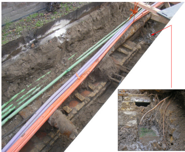
Afb. 8. Deel van goot S1 in het traject Korte Nieuwstraat, gezien tegen de oostgevel van het pand Museumstraat 54 in zuidoostelijk richting. In de inzet is een dwarsaanzicht te zien.
