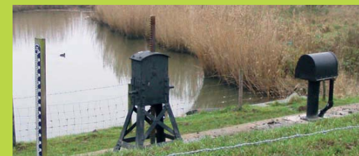
Machinerie van het Johannes Visgemaal in 2006 (foto D. Paalman)
