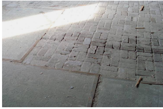
Afb.23 De vloer bestaat deels uit gewapend beton platen en deels uit grijze klinkers.
