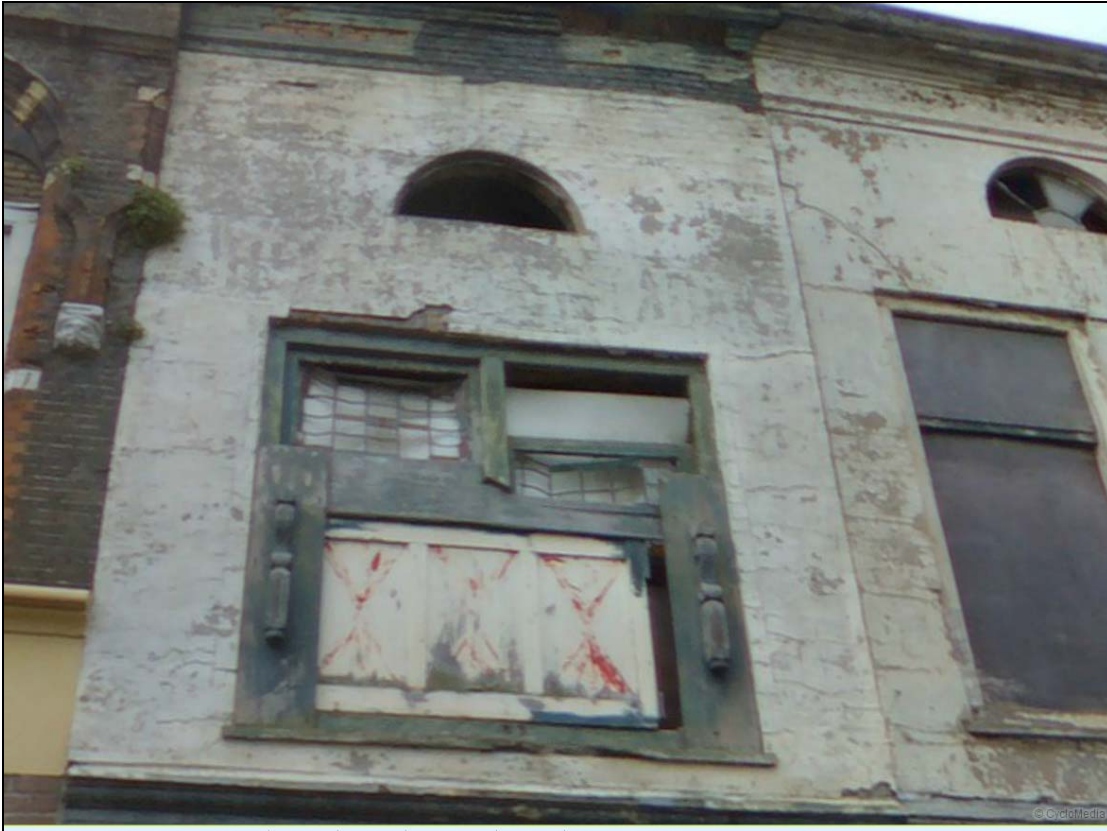
Afb. 8. De voorgevel van het pand aan het Weeshuisplein 19 voorafgaande aan de renovatie (2014). Tussen de twee ramen zijn nog deels de letters te zien van een reclamebelettering. Het laatste woord "tabak" is nog redelijk te lezen.
