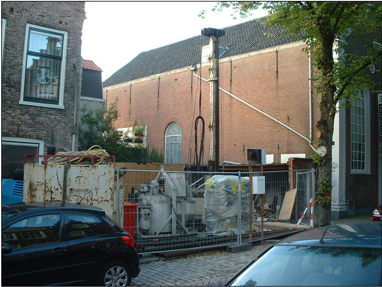
De hij-installatie op het kale bouwterrein. Kans om de zijmuur van de Kunstkerk bijna in volle glorie te zien, voordat hij straks weer schuil gaat achter de nieuwbouw.
