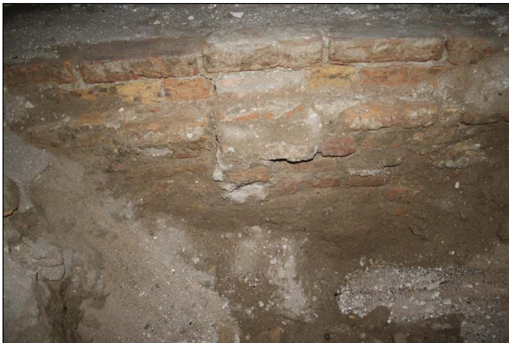
Afb. 7. Eén van de lengtemuren onder de huidige vloer in het achterhuis aan de Groenmarkt 74. Gezien in zuidwestelijke richting (de havenzijde is links, Groenmarktzijde rechts).
