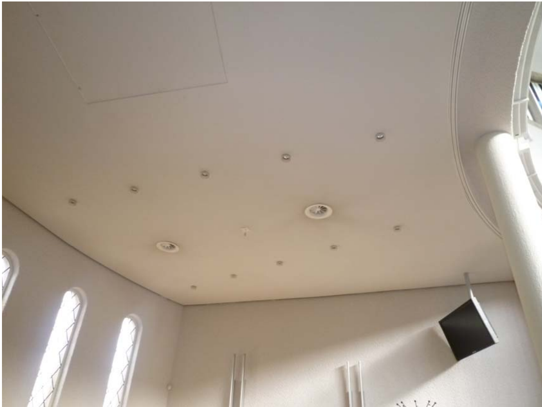
De installaties en leidingen zijn zo veel mogelijk weggewerkt
