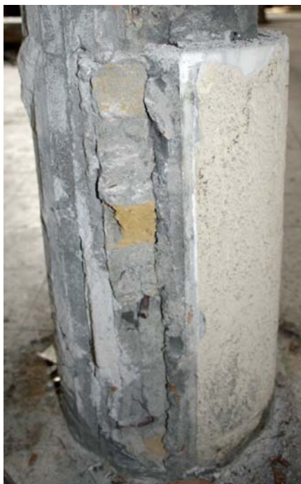
Restant van de marmeren bekleding in de entree, geel overgeschilderd.
