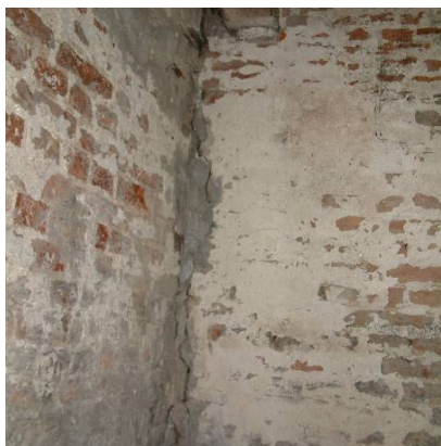
Afb. 13 Kuipershaven 38, begane grond. Aansluiting van de achtergevel op de zuidwestelijke bouwmuur. De muren zijn hier koud tegen elkaar aan gezet.
