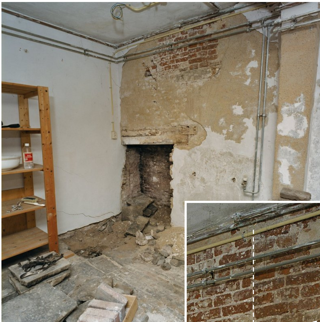
Afb. 20 Kuipershaven 38, begane grond. Gezien richting de achtergevel (rechts) en de scheidingsmuur met Kuipershaven 37 (links). Midden boven is een verticale voeg te zien. Onder deze voeg is een stuk natuursteen te zien (inzet). Mogelijk wijst dit op een dichtgezette gevelopening. RCE 501.389
