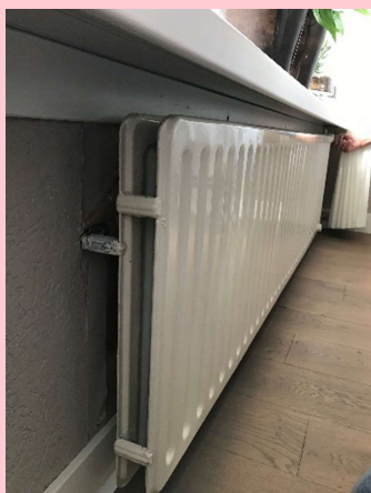
2-leden radiatoren begane grond
