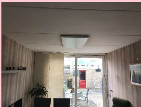
Infraroodpanelen op de begane grond
