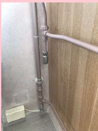
Afgekapte oude cv-leidingen naar begane grond
