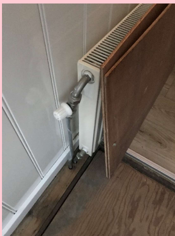
Radiatoren boven voorzien van thermostaatkranen
