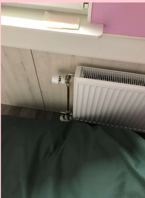
Radiatoren voorzien van thermostaatkraan
