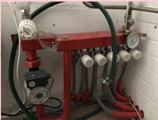
Vloerverwarmingsverdeler nieuw (na renovatie)
