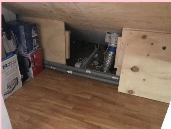
Leidingverloop achter kopschotten
